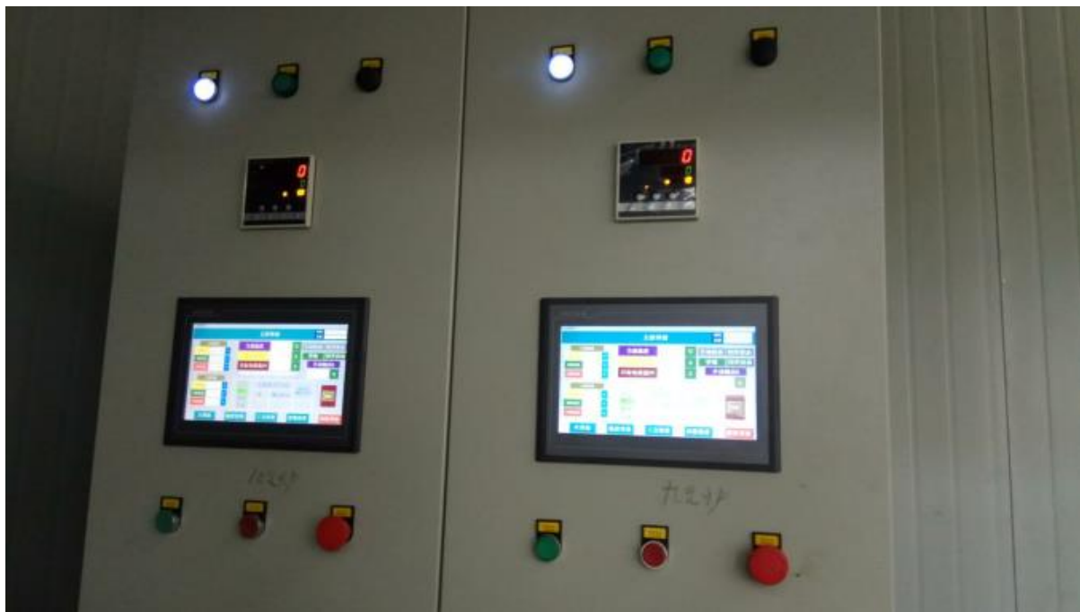
现场控制柜（图一）
